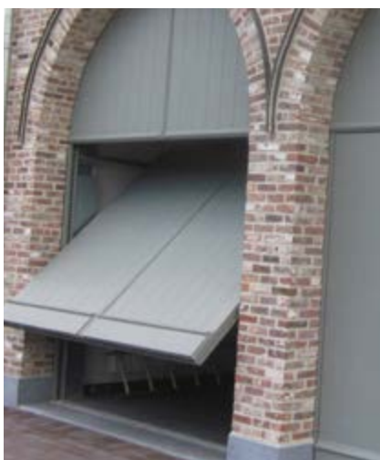
Buiten de gevel draaiende kantelpoort
